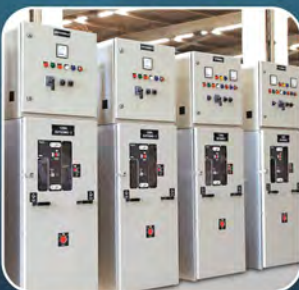
HT & LT Switchgear
