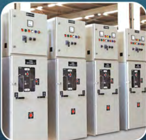
HT & LT Switchgear
